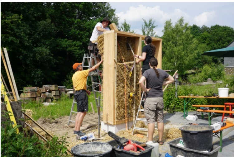
Die Teilnehmer beim Strohbau-Workshop im Hessenpark konnten selbst erleben, wie sich das Bauen mit Stroh anfühlt.
